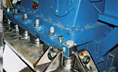
Redutor de engrenagens
